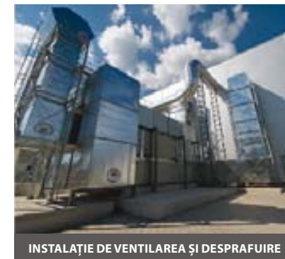
INSTALAȚIE DE VENTILAREA ȘI DESPRAFUIRE
