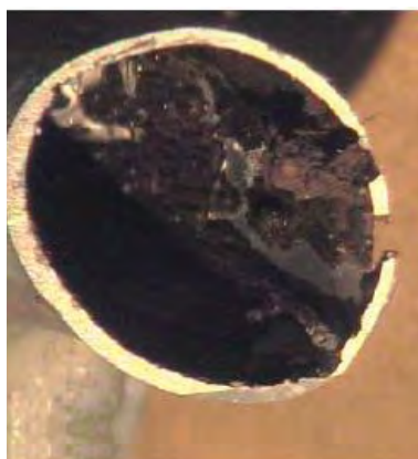
Gaura de coroziune în conducta de racordare
